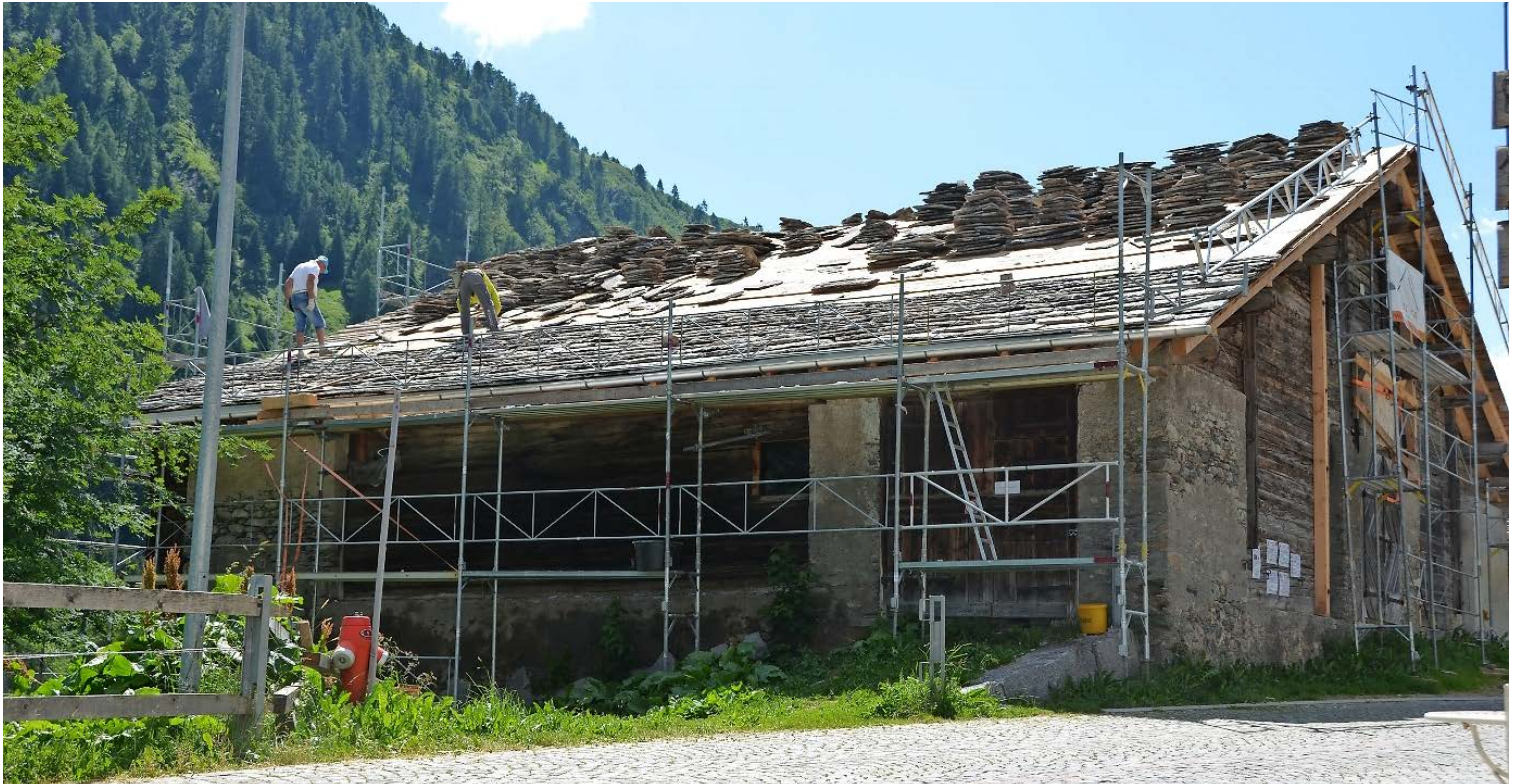
Weil durch das Steinplattendach Wasser eindringen konnte, wurde eine Sanierung notwendig.
